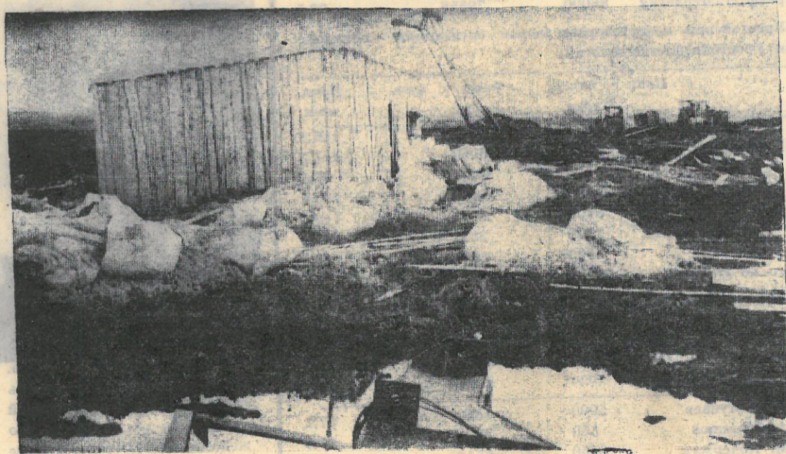
20 рваных кулей буровой глины по 760 кг, 7 пакетов цемента по 2 тонны каждый. Более 15 тонн глины, 14 тонн цемента приведено в негодность. Лужа дизтоплива — одна из трех емкостей, рассчитанных на 50 кубометров, течет — потеряно более 20 тонн соляры... Таковы результаты зимнего завоза сыпучих материалов и ГСМ на Р-57 (Южно-Таркосалинская НРЭ).
