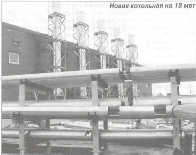
Новая котельная на 18 мвт
