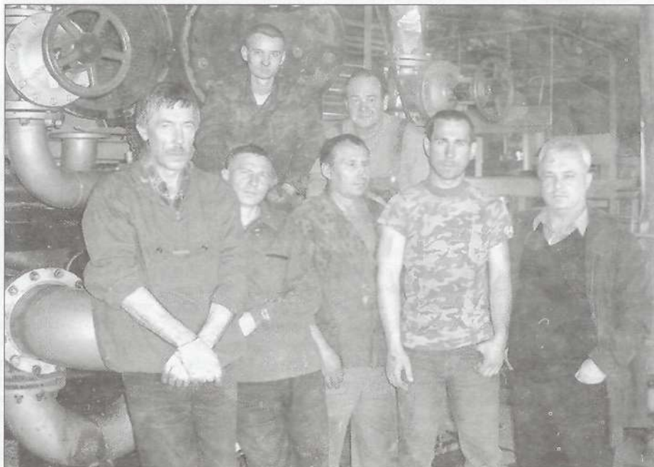
Ремонтная бригада слесарей котельной № 3 филиала ПКС п. Уренгой. Подходит к концу ремонт бойлеров (или теплообменников), начатый 1 мая. Кроме этих работ здесь предстоит произвести чистку, промывку и гидравлику всех котлов, а также капитальный ремонт одного котла. Полностью подготовка котельной к отопительному сезону должна закончиться в конце августа.
